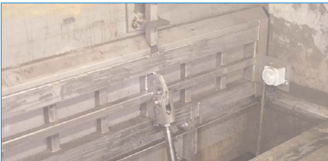
Klappe gegen Hochwasser geschlossen
