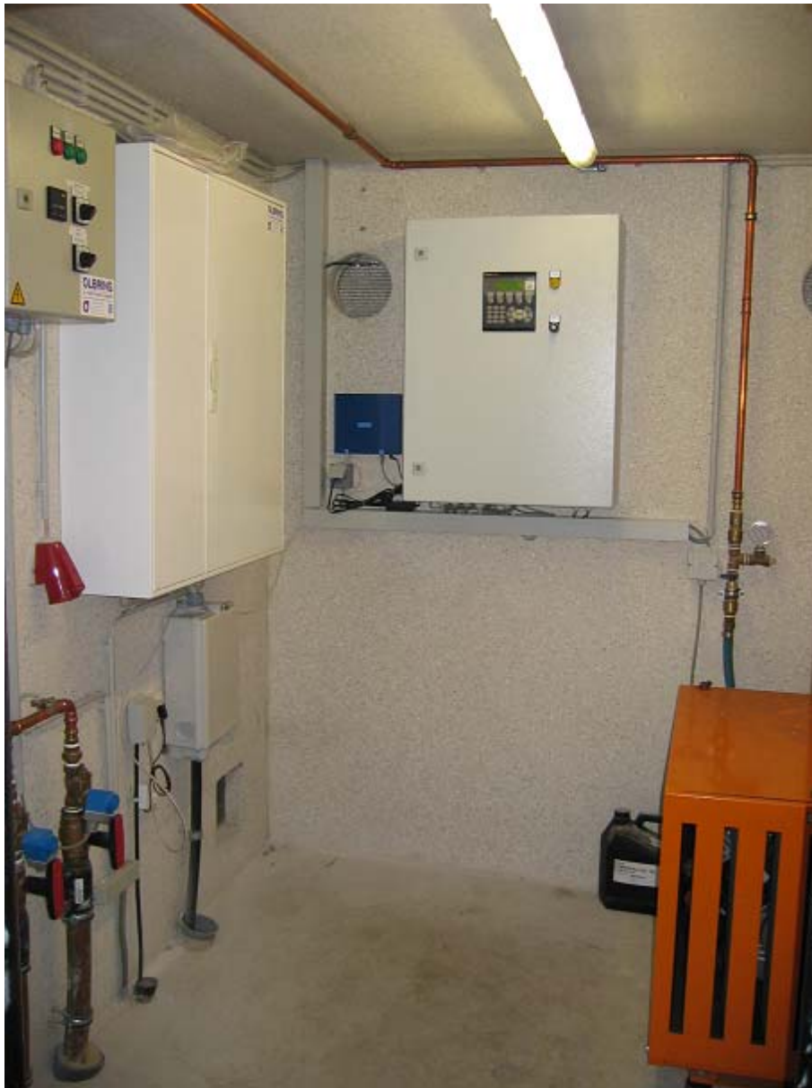
TeleMatic-Station in einem Kompressorwerk zur Datenerfassung
