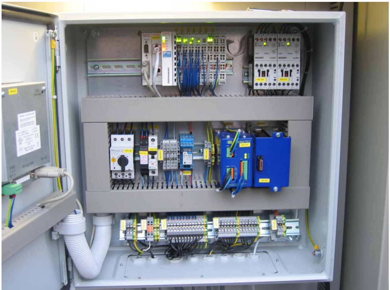
TeleMatic-Station mit 3-Phasen-Leistungsmessung
