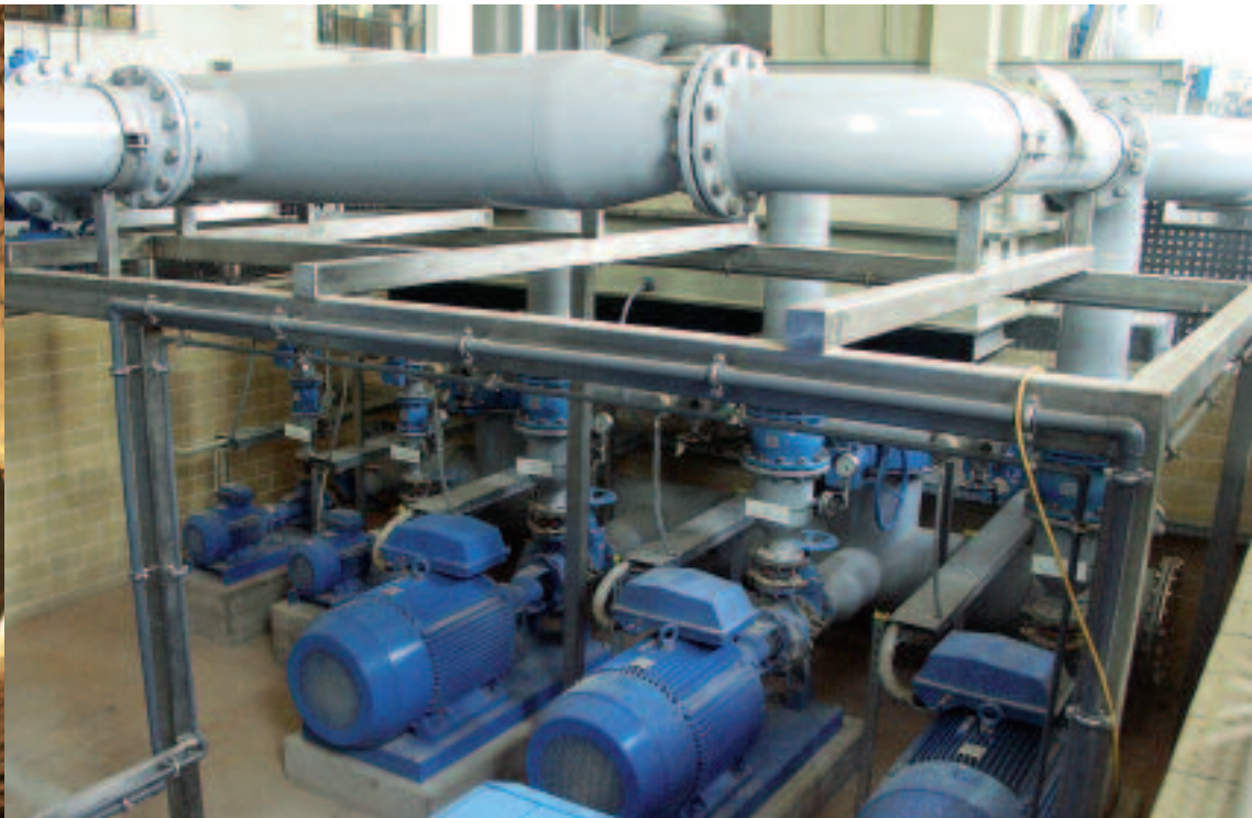
Blick auf den Rieseler, der zur Entsäuerung des Wassers dient
