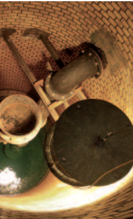
Einer von sieben Brunnen mit Brunnenpumpe zur Förderung des Rohwassers
