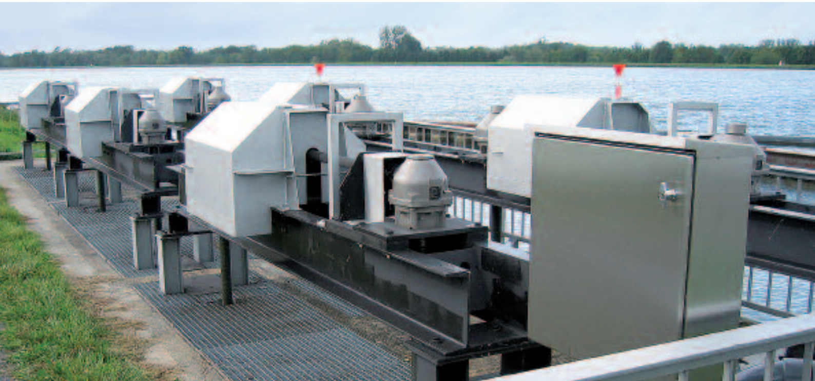
Antriebstechnik für die drei Schütze des Rheinwasser-Entnahmebauwerks im Teilpolder 2.
