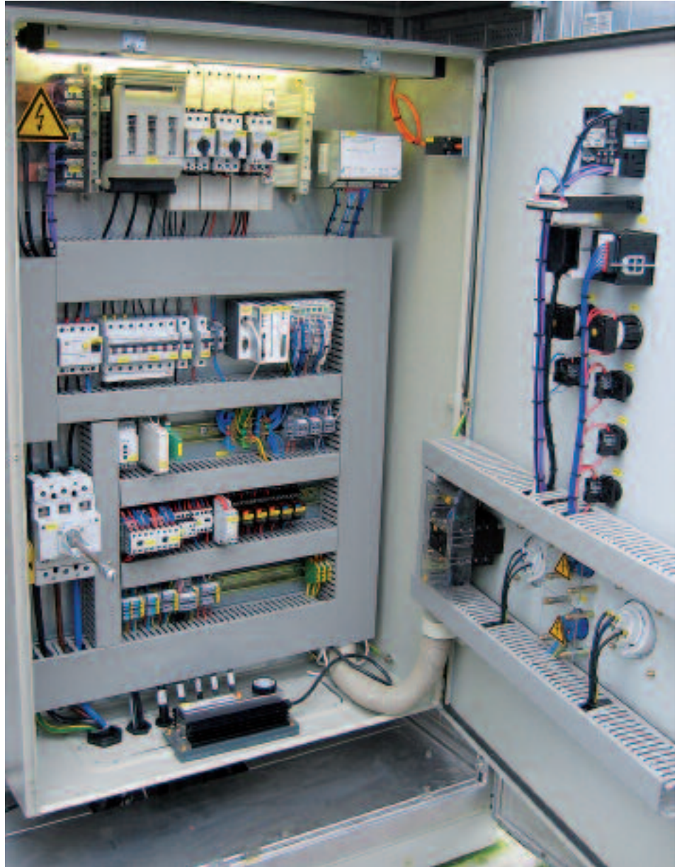
Überwachung eines Durchlassbauwerks mit einem TeleMatic-Controller SMART-400
